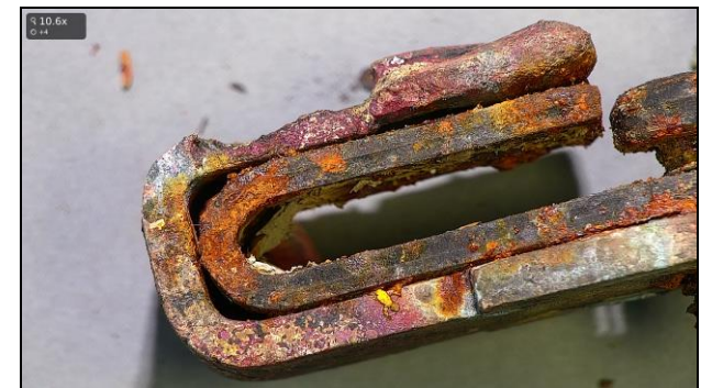
Domages provoqués par des arcages répétés sur un contact d'armoire de commande de déligneuse. Origine de l'incendie d'une importante scierie (microscope optique 3D x11).
