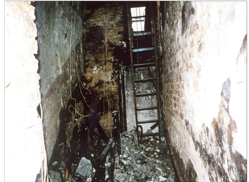
Départ de feu à la base de la cage d'escalier ; 3 morts.
