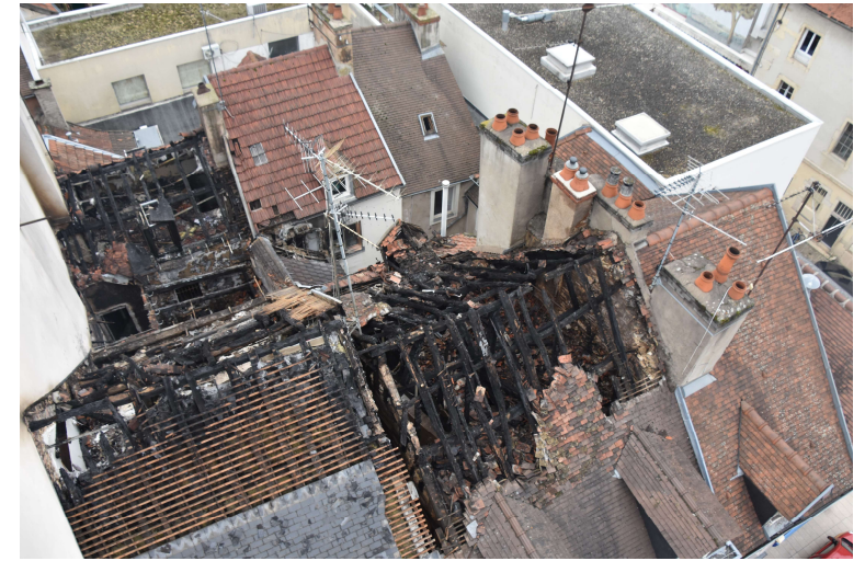
Départ de feu au niveau de containers poubelles à la base d'un escalier. 1 mort.
