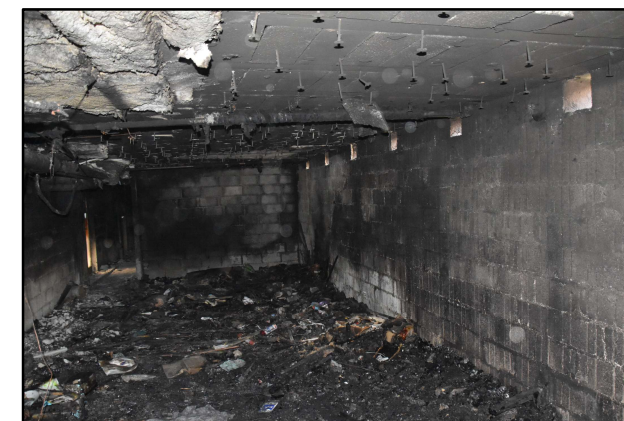
Zone origine, départ de feu dans les caves.
