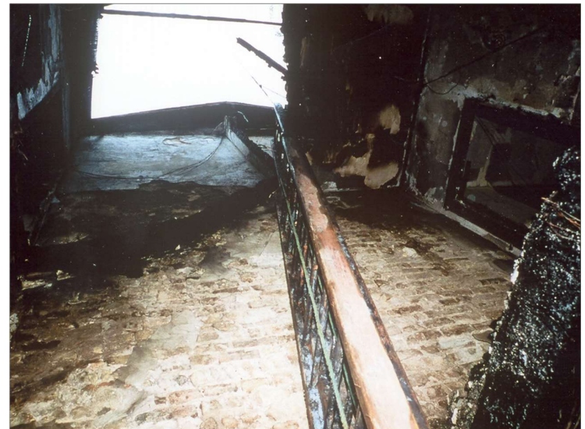
Même cage d'escalier après l'incendie.
