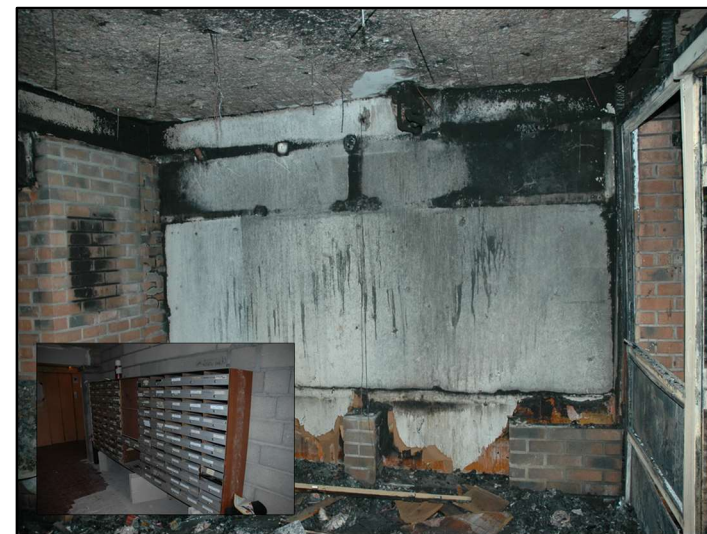
Hall d'entrée de la tour, origine de l'incendie au niveau de boîtes aux lettres.
